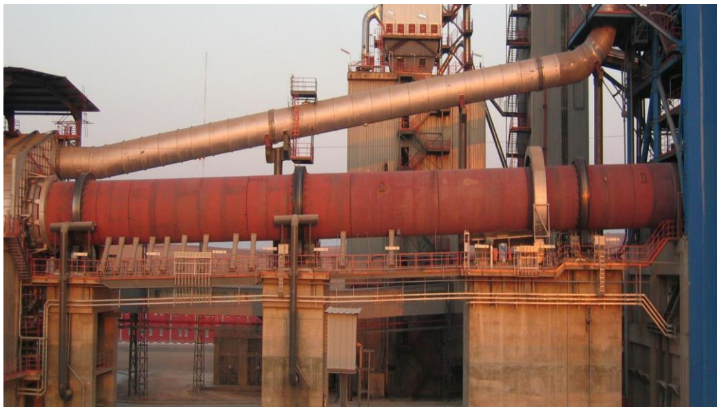
Figure (I.4) : Four rotatif de cimenterie.
