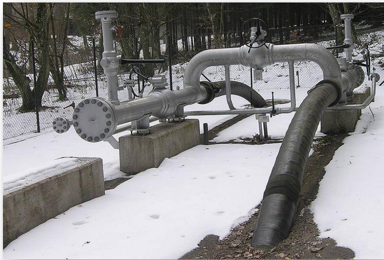
Figure 1.10 Poste de coupure en Suisse. [11].
