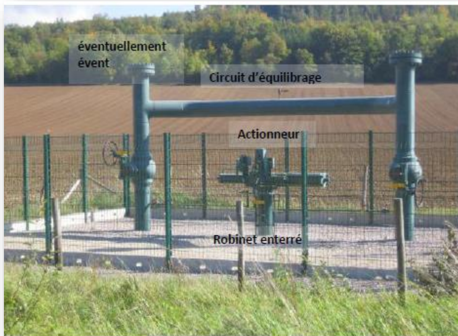
Figure 1.8 Postes de Sectionnement
