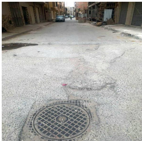
Fig II.16 : Affaissements localisés autour des regards
