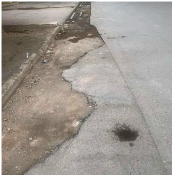
FigII.09 : Arrachement massif de la chaussée
