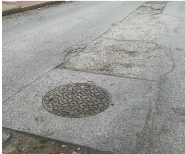
Fig II.15 : affaissements localisés autour des regards
