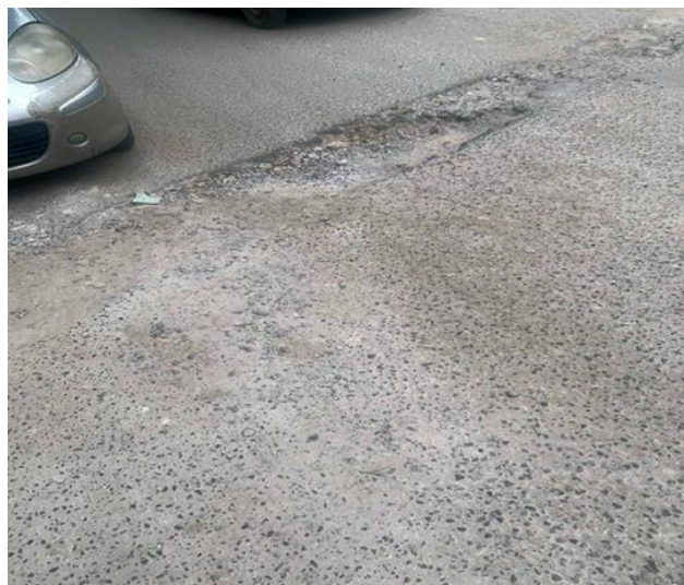
Fig II.12 : fissures importantes+ présence d'eau stagnante.
