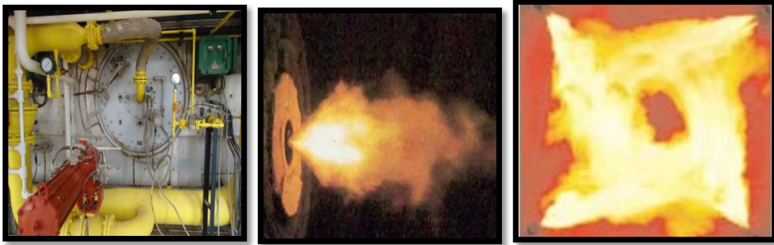
Figure I.11 : Brûleurs dans la chambre de combustion.
