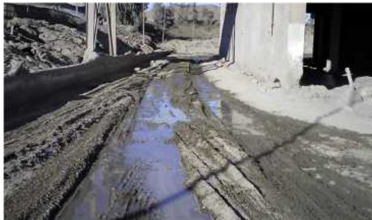
Figure II.5 : Mauvais état du sol.
