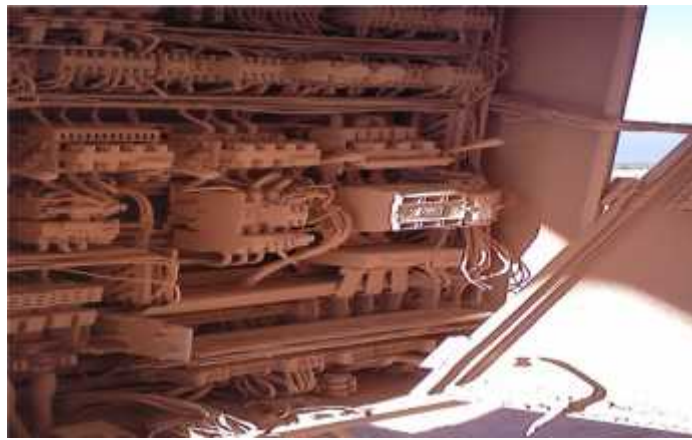
Figure II.9 : Armoire électrique ouverte.
