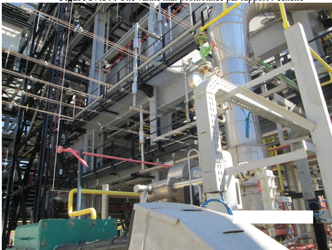
Figure IV.15 : Un baromètre très mal positionné inaccessible à l'opérateur
