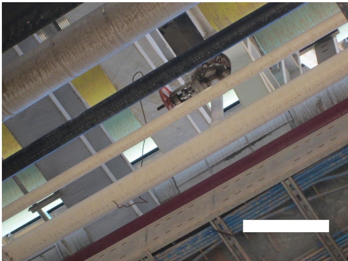
Figure IV.12 : Une vanne inaccessible
