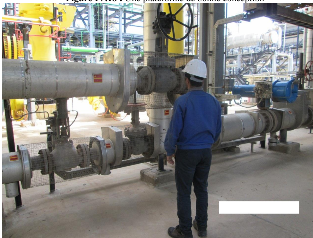
Figure IV.19 : Une vanne difficilement accessible par l'opérateur (très élevée)
