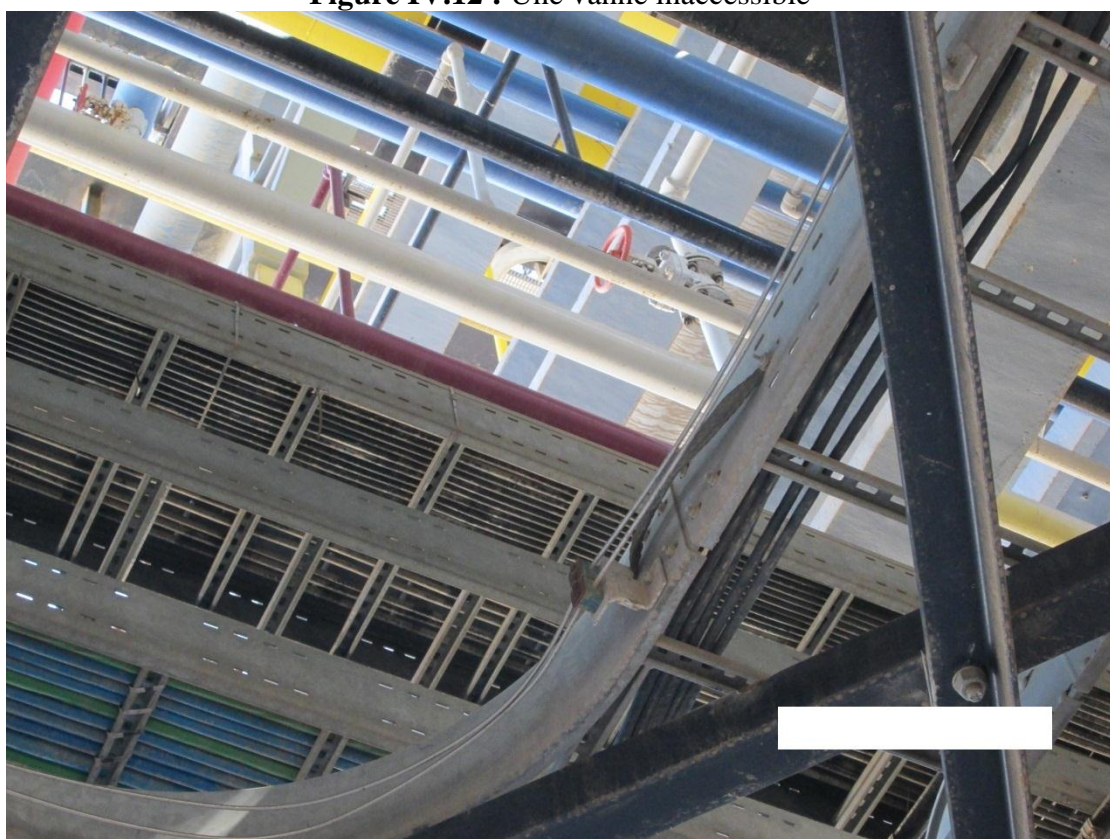
Figure IV.13 : Une vanne inaccessible
