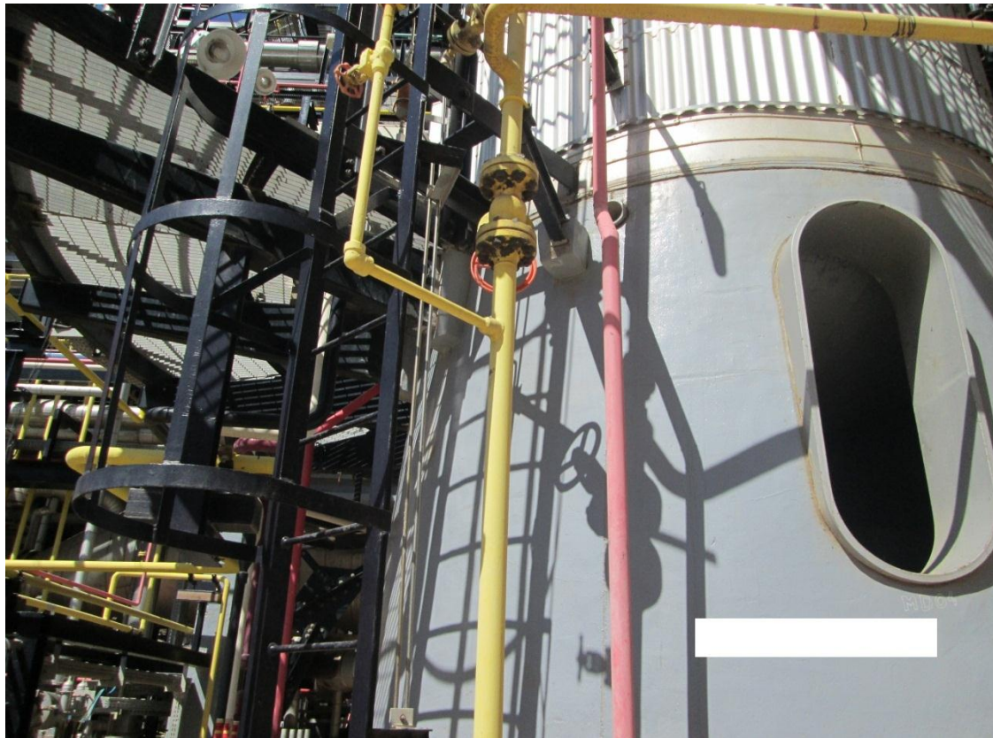
Figure IV.14 : Une vanne mal positionnée par rapport l'échelle
