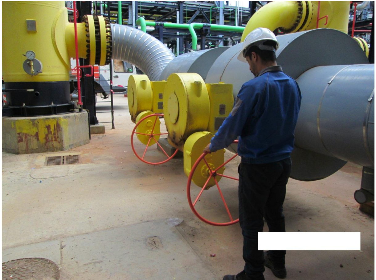
Figure IV.7 : Une vanne difficilement accessible par l'opérateur (très bas)
