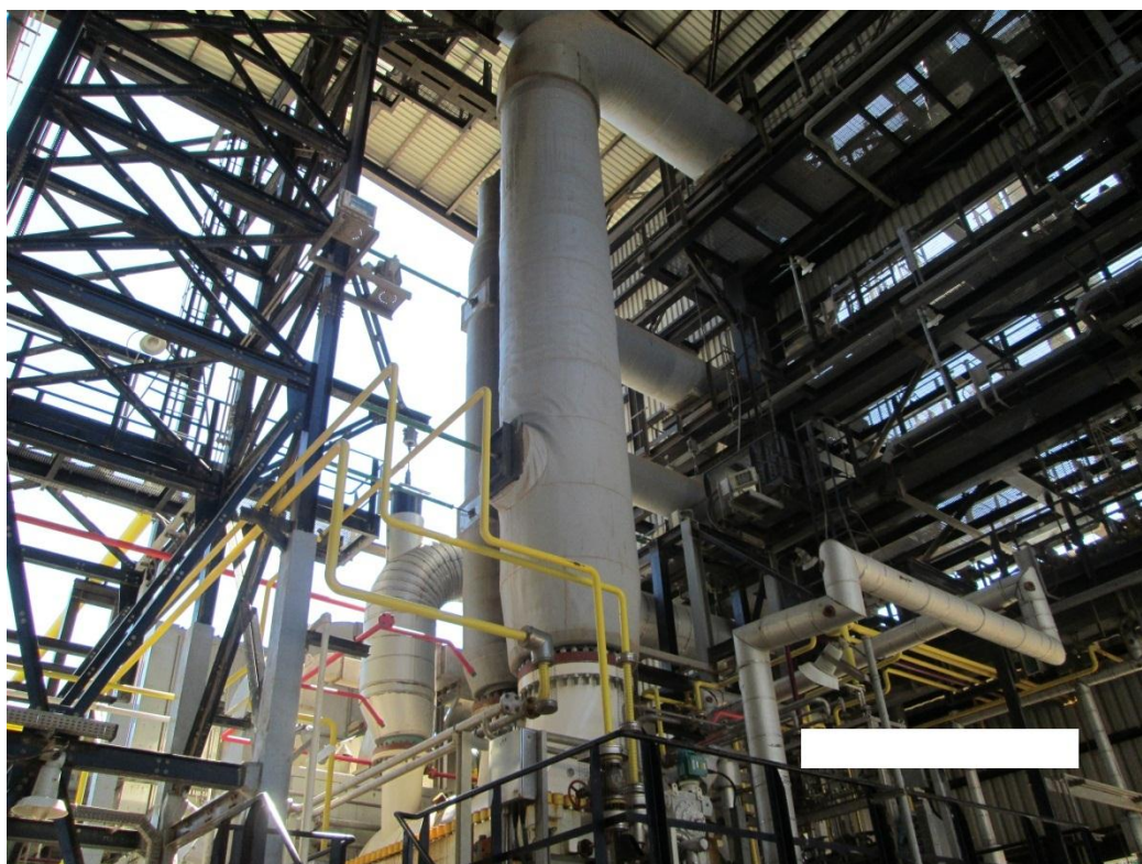
Figure IV.20 : Un compresseur mal conçu de point de vue maintenance
