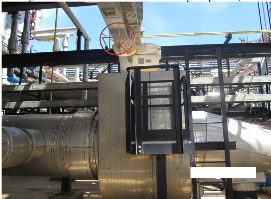
Figure IV.8 : Une plateforme de mauvaise conception
