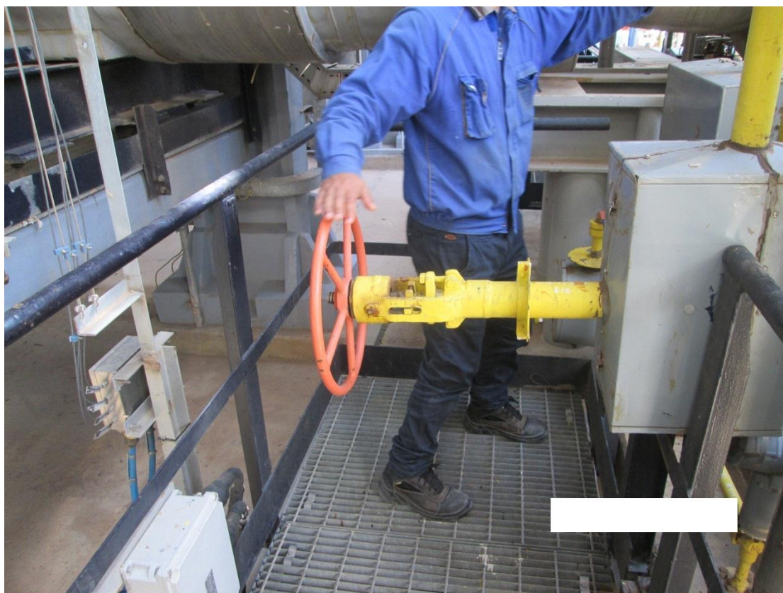
Figure IV.9 : Une vanne bloquant le passage de l'opérateur
