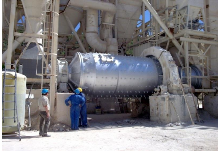
Figure III-2 : Broyeurs de ciment gris
