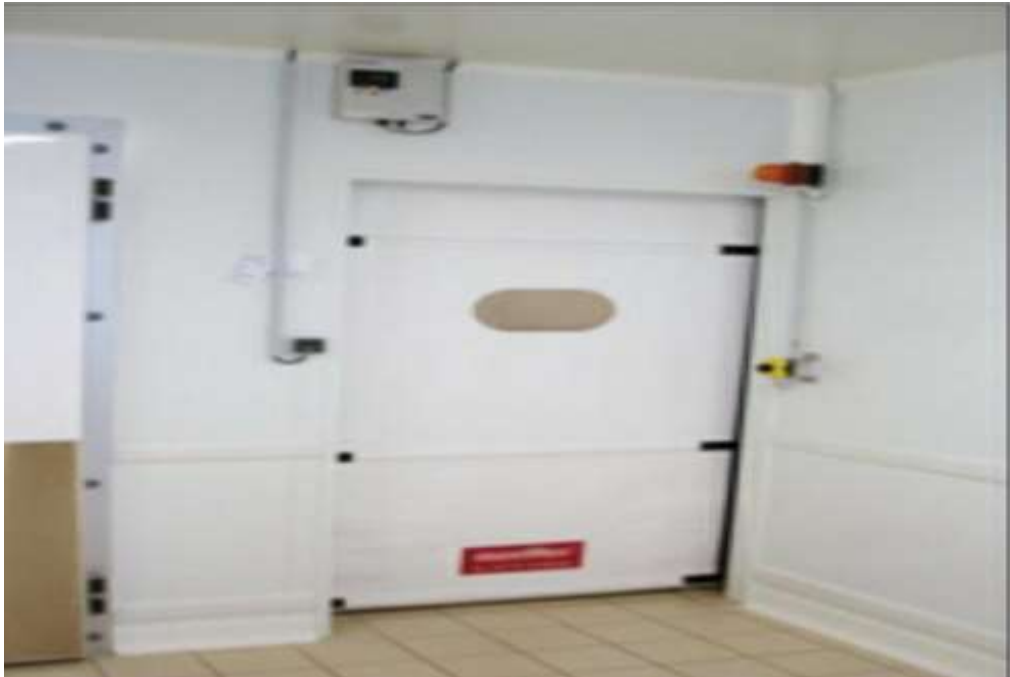
Figure 8: Porte à ouverture automatique avec Hublot
