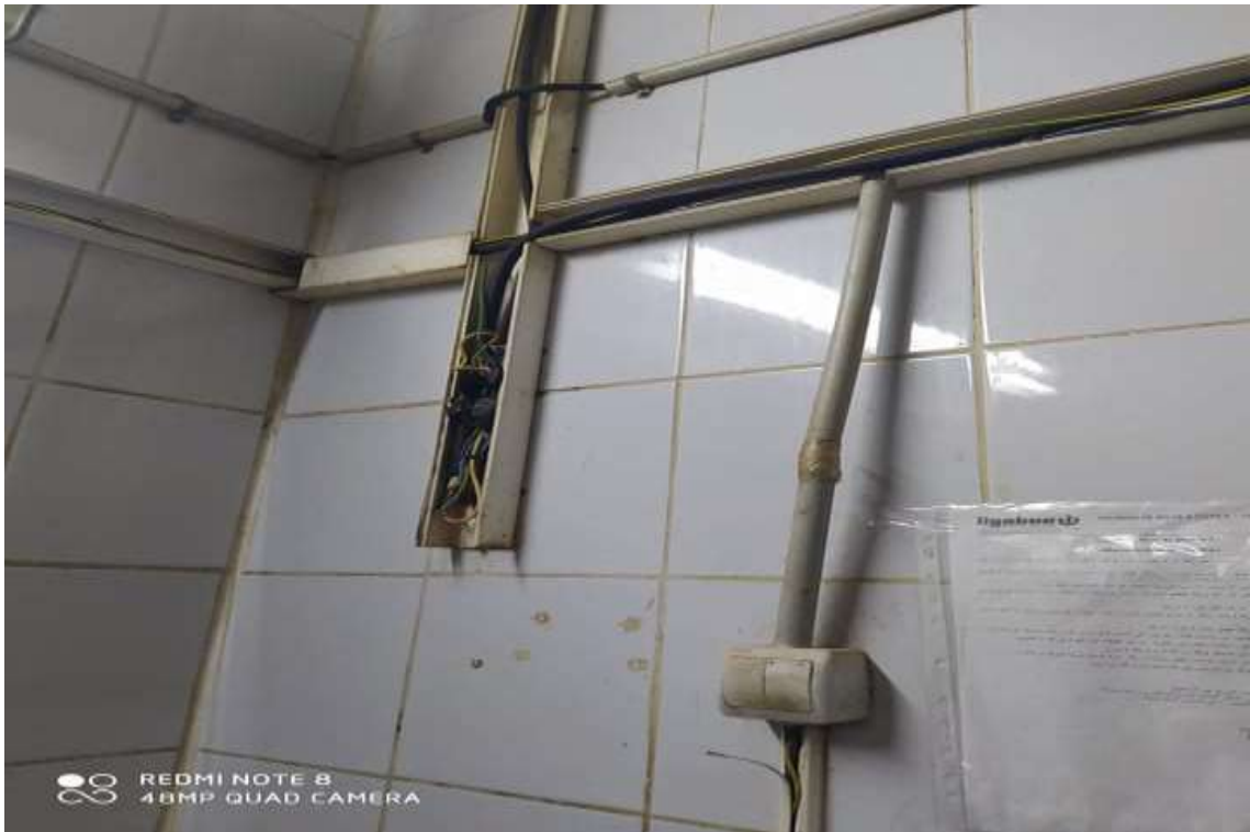
Figure 19: Apparition des câbles.
