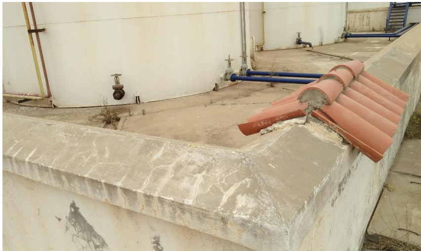
Figure 4.5 Cuvette de rétention
