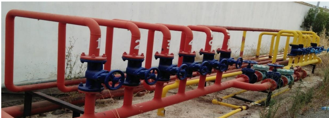
Figure 4.10 Vannes d'intervention (Mousse + Eau)
