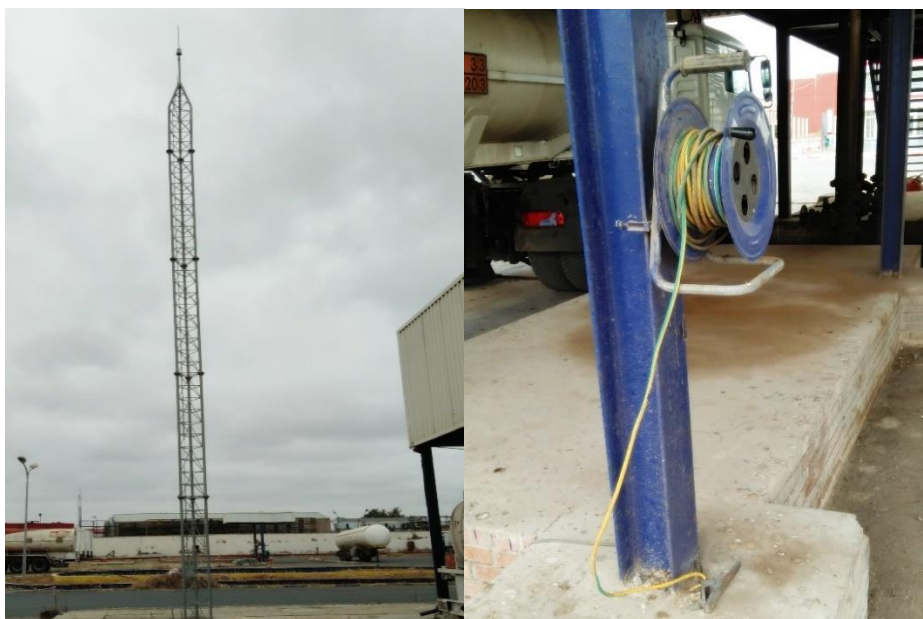
Figure 4.8 Parafoudre et mises à la terre (Poste de dépôtage et Unité)
