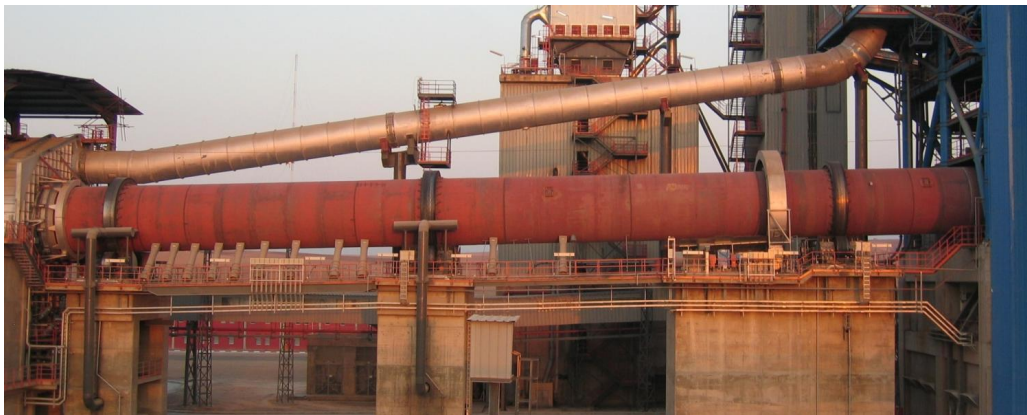
FIGURE I.20 – Four rotatif de cimenterie.
