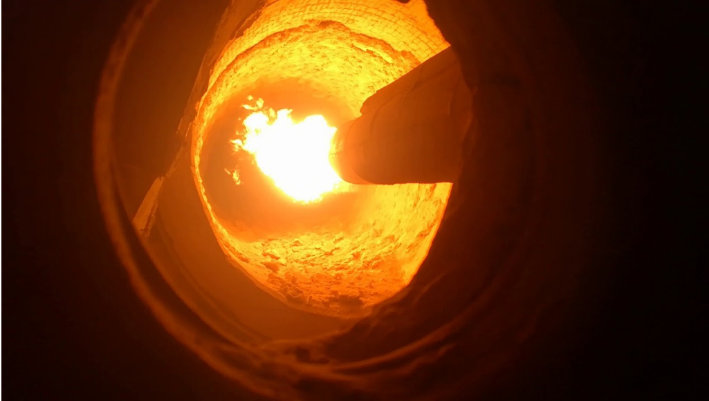
FIGURE I.24 – La flamme brûleur de four rotatif.
