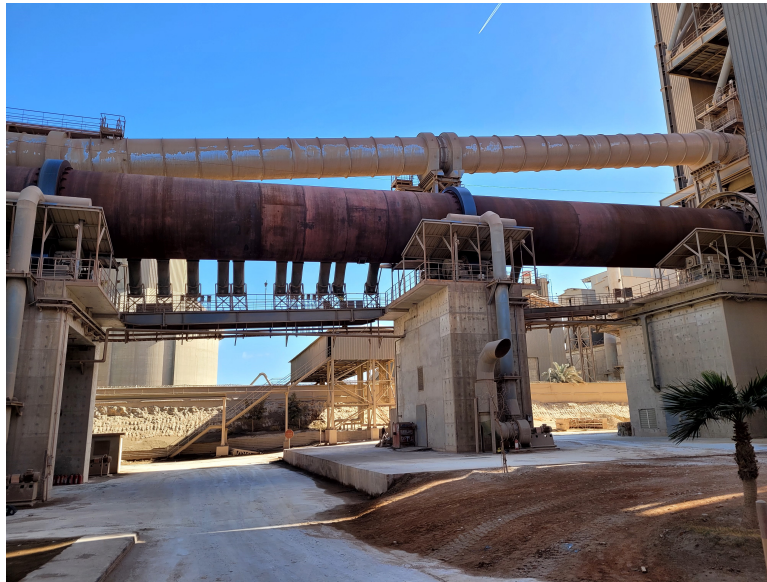
FIGURE III.2 – Four rotatif d'usine (cimenterie de Zahana « S.C.I.Z » – MASCARA).
