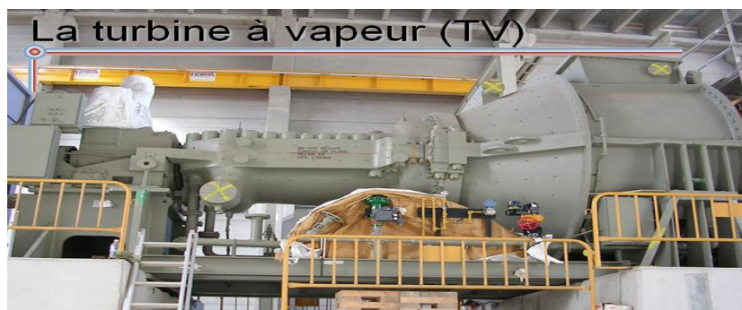
Figure III.4 : Turbine à Vapeur.
