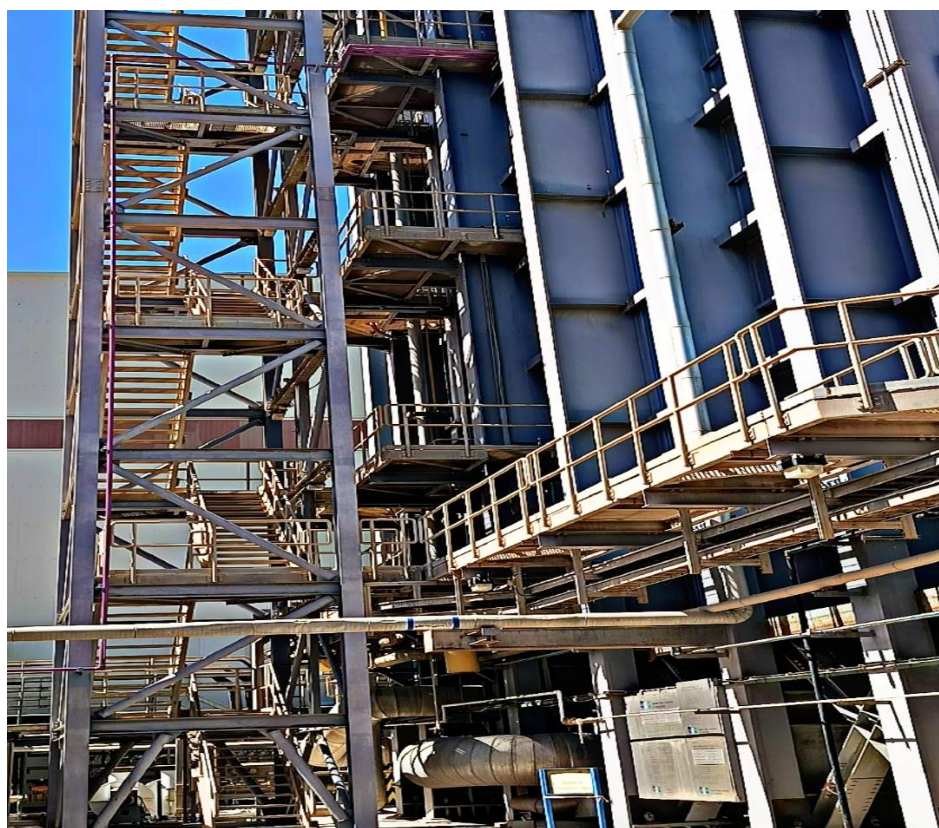
Figure IV.3 : Escaliers et Plateformes de travail en chaudière.
