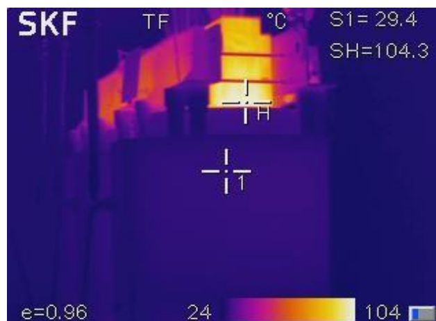
Figure IV .22 : Image thermique du transformateur.
