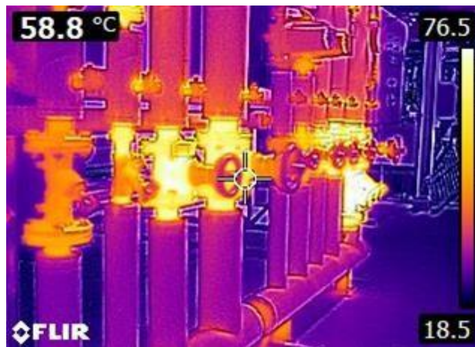
Figure II.9 : contrôle et bilan thermique et maintenance industrielle préventive par la thermographie.
