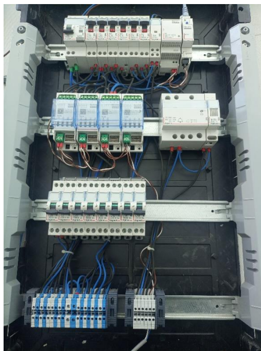
Figure III. 38 : L'armoire de câblage.
