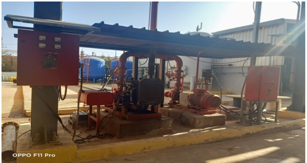
Figure I.20 : Pompe d'eau d'incendie électrique et pompe d'eau d'incendie diesel Du site « ADWAN »
