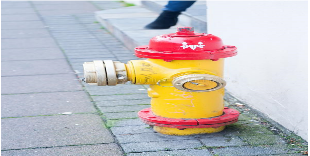
Figure I.21: Bouches d'incendie du site « ADWAN »
