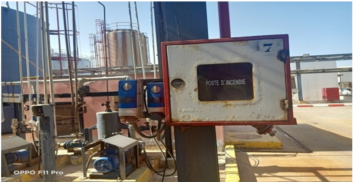
Figure I.16 : Poste Anti-incendie sur site « ADWAN »
