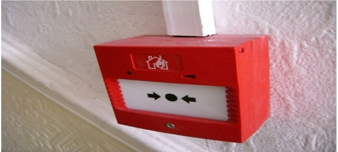
Figure I.27 : Type de déclencheur manuel d'incendie utilisé au sein de la société « ADWAN »
