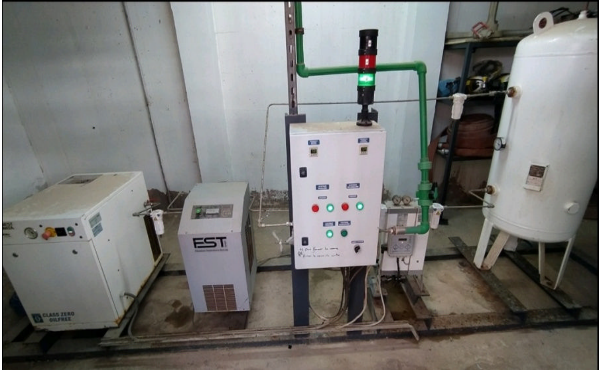
Figure I.32 : Compresseur d'air respirable
