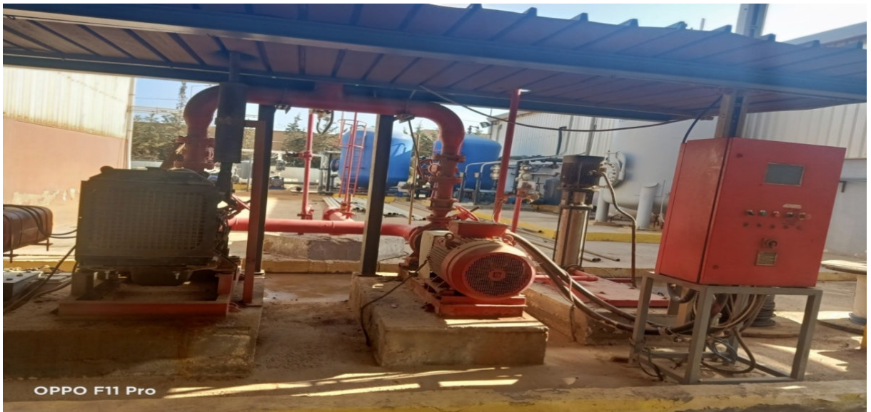
Figure I.19 : Pompe «JOCKEY » d'eau douce incendie du site « ADWAN »
