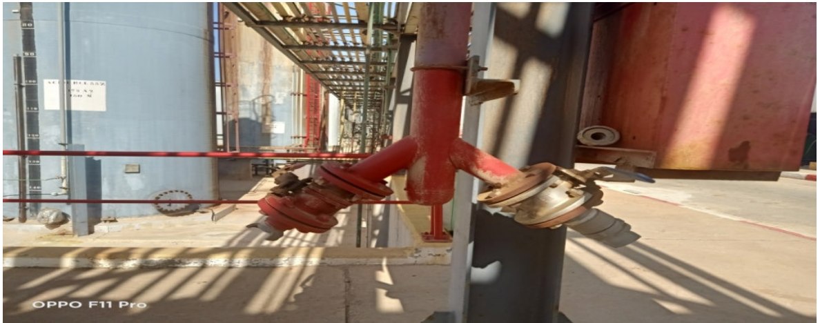
Figure-17 :Robinet d'incendie arme (RIA) sur site« ADWAN »
