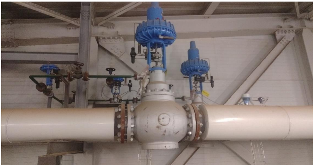
Figure II-15: vanne de régulation utilisée dans le processus
