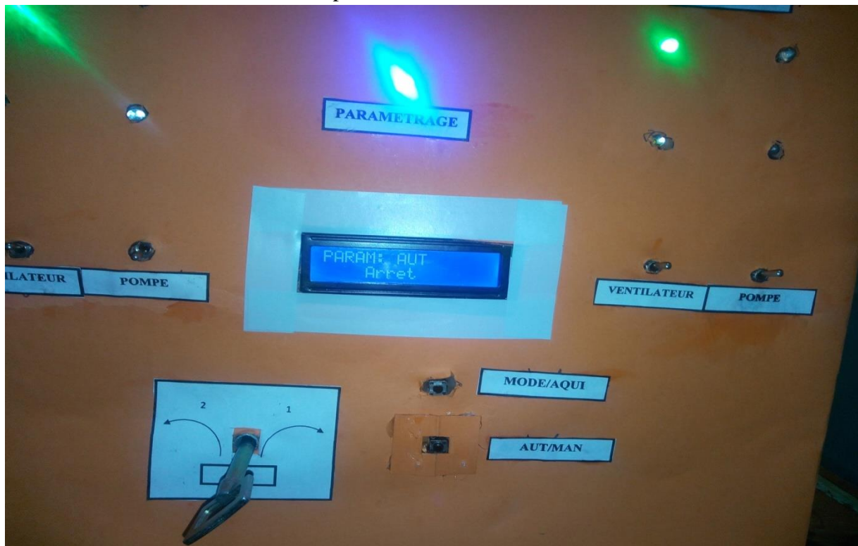
Figure III.13 : La centrale de commande en mode paramétrage
