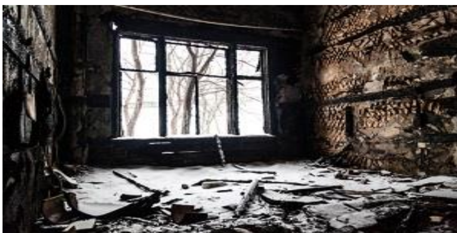
Figure 1-2 : Conséquences d'un incendie sur un bâtiment
