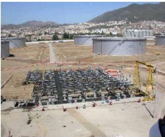
Figure VI.1. Bacs de stockage et le manifold
