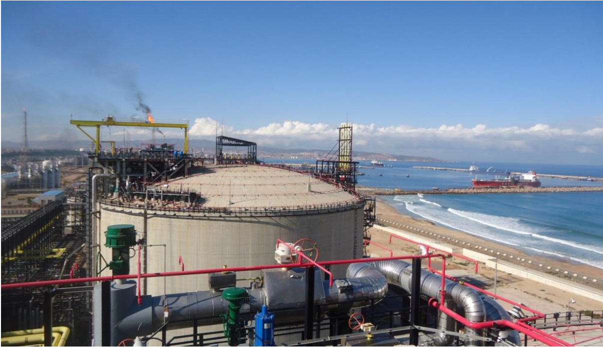
Figure N° 10 : bac de stockage de butane de : 12 000m 3
