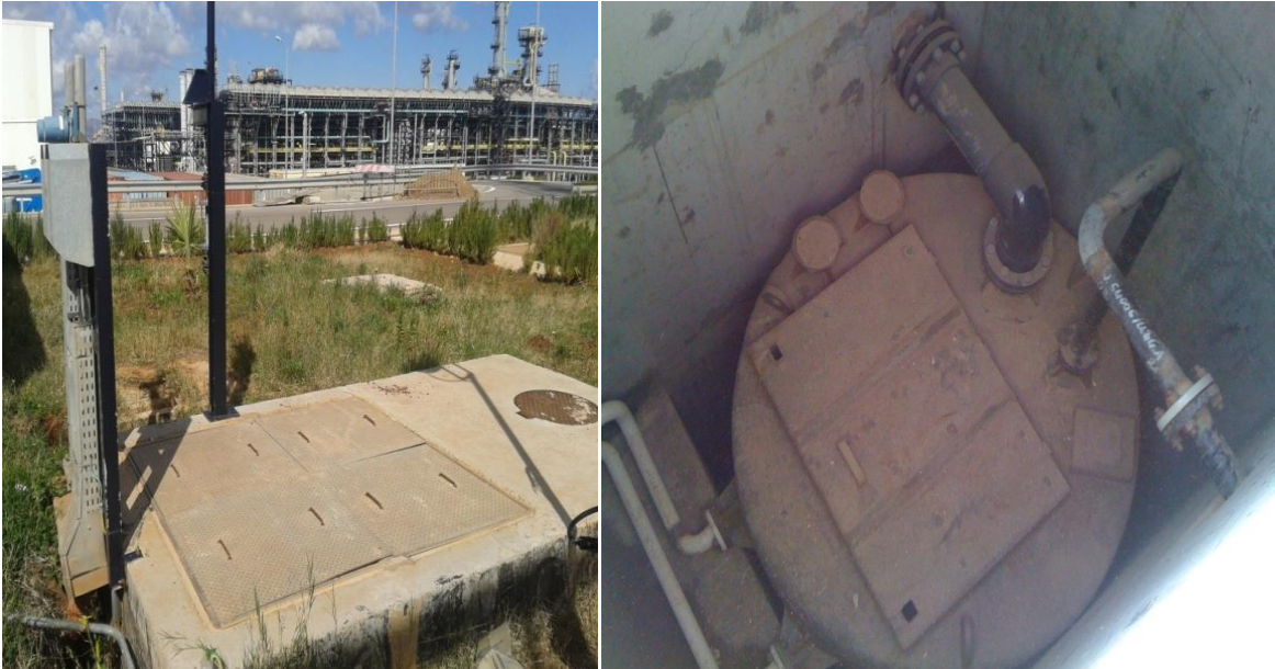
Figure N°15 : Équipements stations de relevage.
