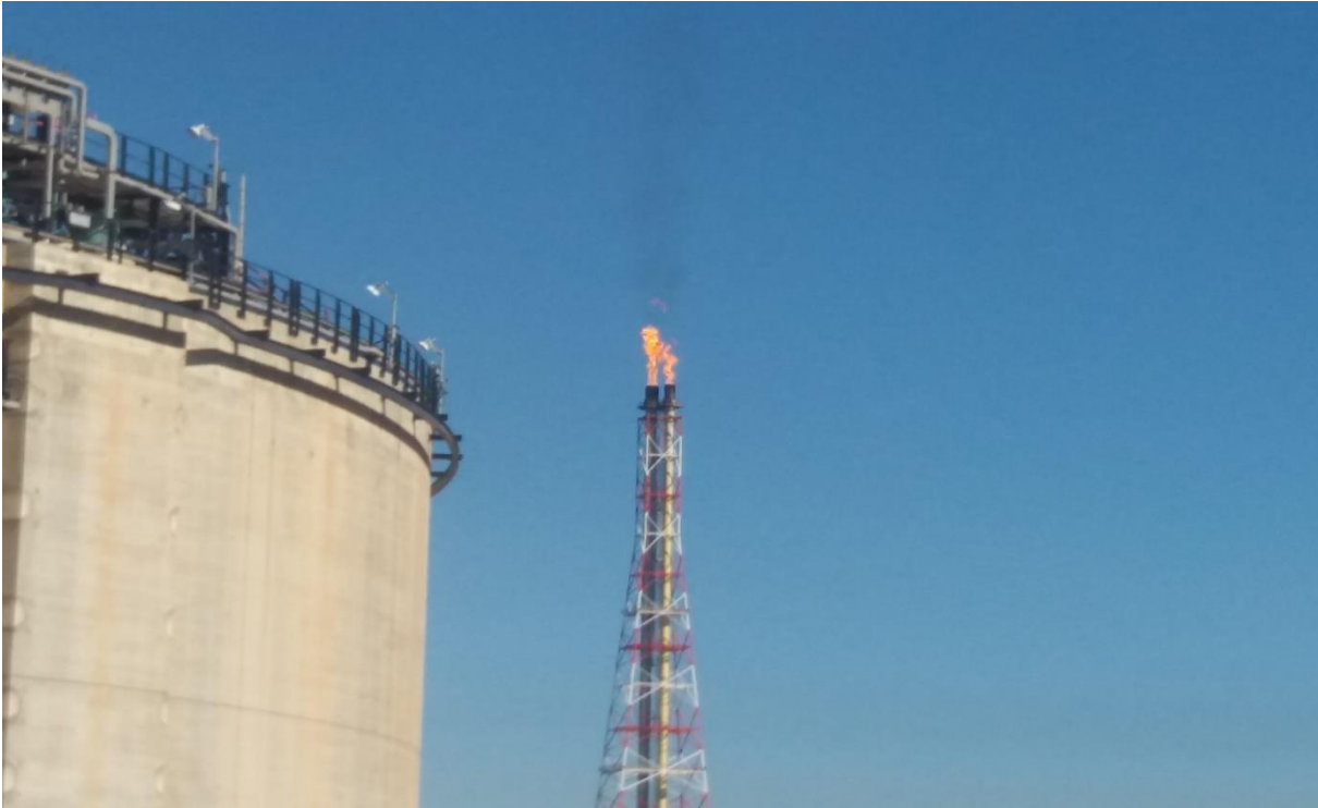
Figure N°24 : Torche chaude haute pression.
