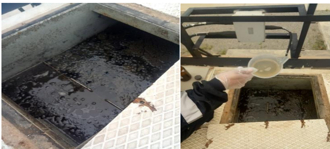
Figure N°42 : le bassin clarificateur A.
