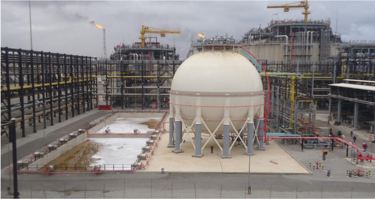
Figure N°11 : sphère de stockage de gazoline : 1 800 m 3 .
