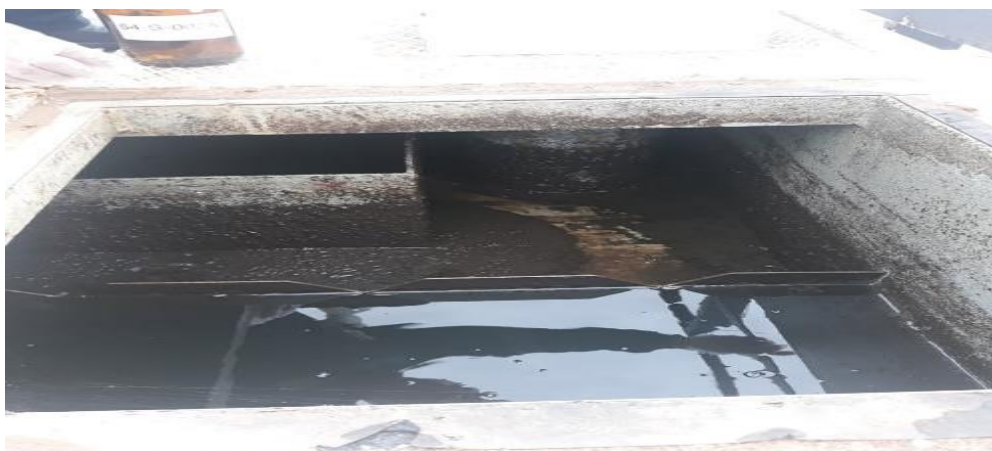
Figure N°45 : le bassin clarificateur A.
