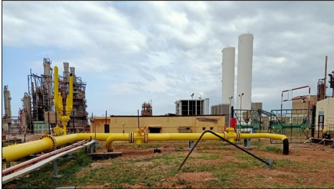
Fig.21 L'arrivée du Gaz naturel de RTO vers unités ammoniac I et II
