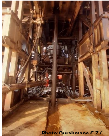
Figure 15 : Blow out preventers (BOP) au niveau du puits TFNW 7.
