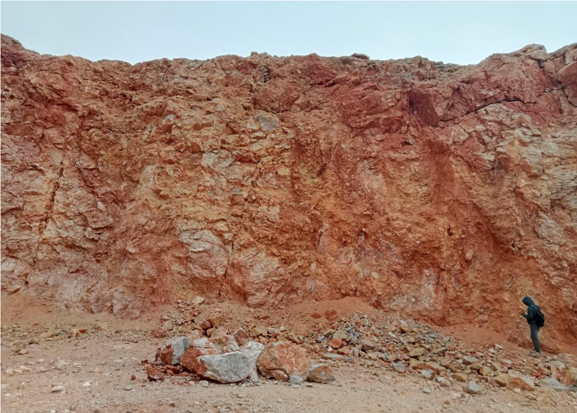
Photo 19.1: faille secondaire B au niveau 635m, marquée par une la zone de broyage et des fracturations.
