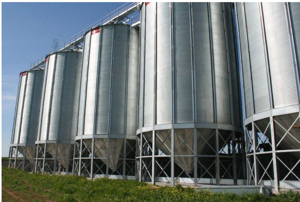
Figure 13 - Silos verticaux en métal à fond conique
