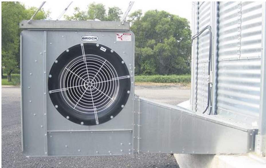
Figure 23 - Système de ventilation des silos
