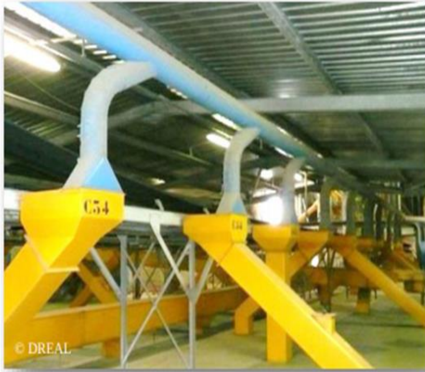
Figure 24 - Aspiration de poussières centralisée sur un convoyeur
