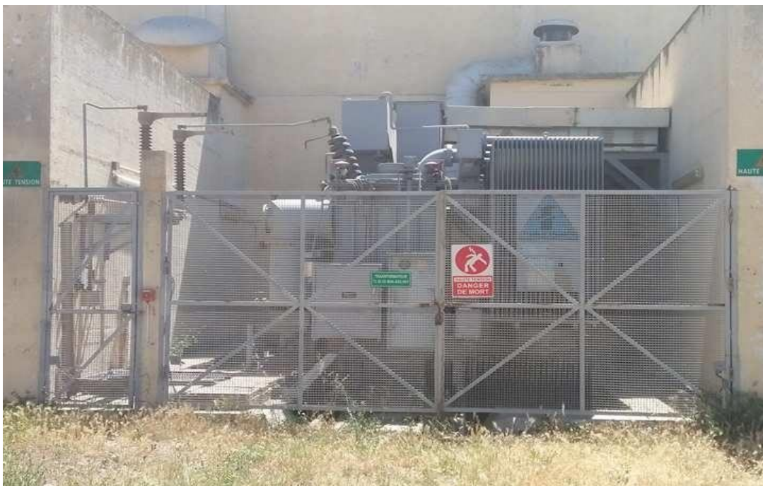
Figure 4.2 Transformateur T 3 63/5.5 KV
