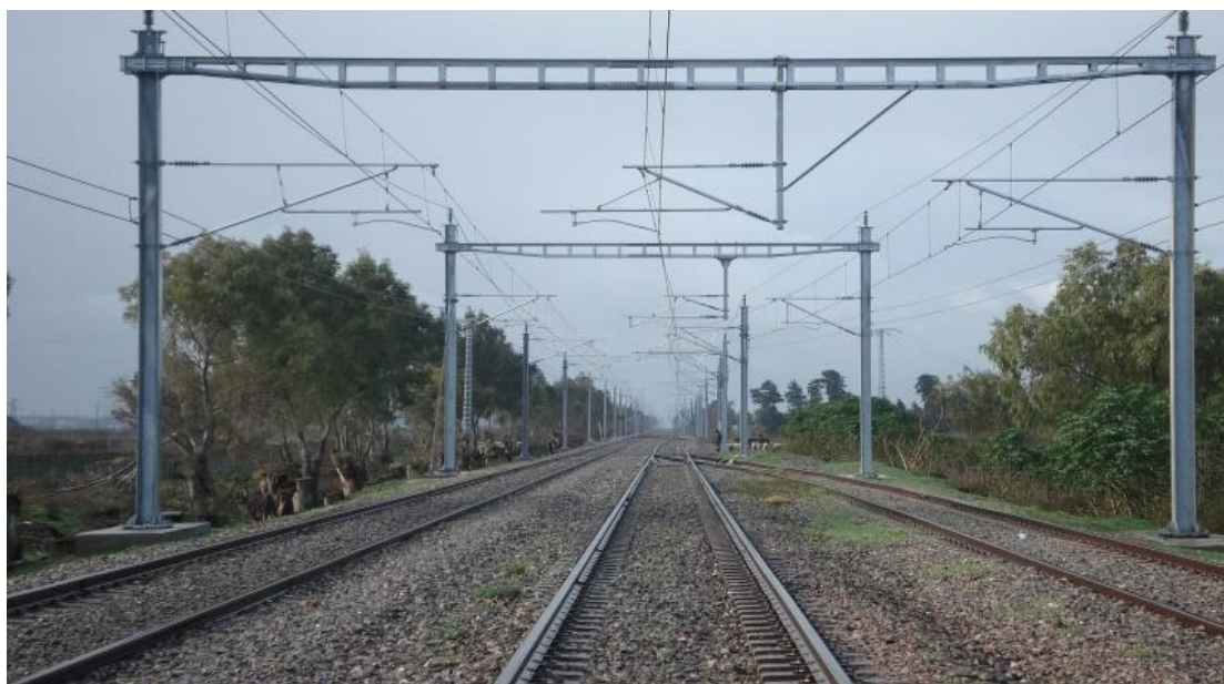
Figure I-3 : La ligne aérienne de contact [5].
