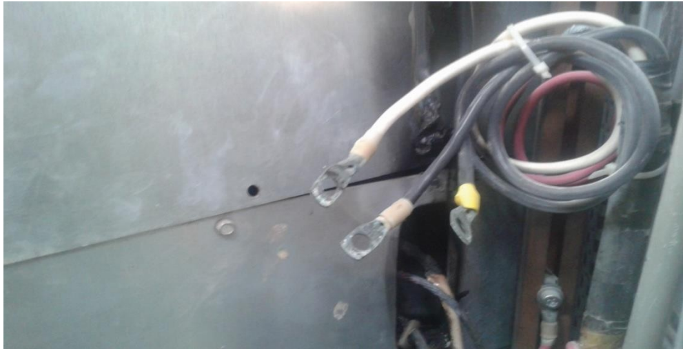
Figure 2.14 incident salle électrique coffret compresseur
