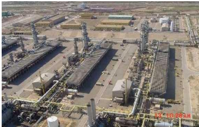
Figure II. 8 : Trains de traitement de GPL du GP1/Z.
