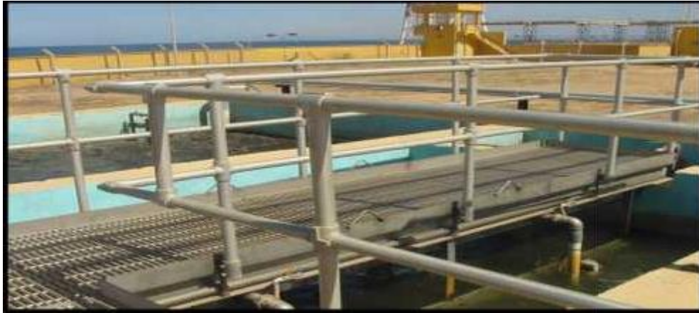
Figure II.11 : Station d'épuration de GP1/Z.
