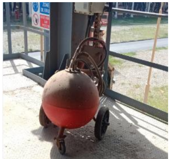
Figure III.11 : Extincteur à poudre.
