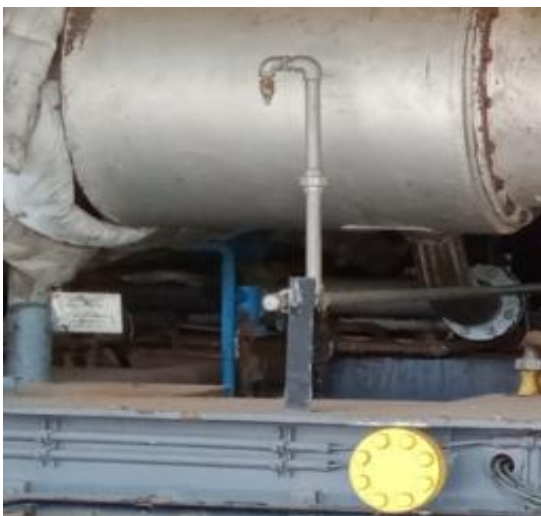
Figure III.10 : Sprinkler sous eau.
