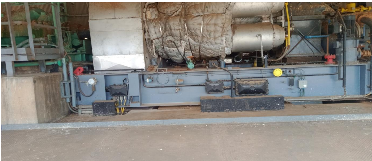
Figure III.4 : Turbine à gaz SULZER S3 au niveau de complexe GP1/Z.
