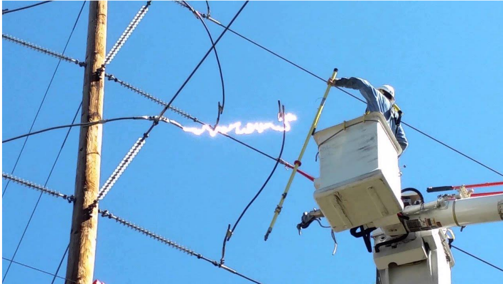
Figure 22 : Explosion au danger électrique.
