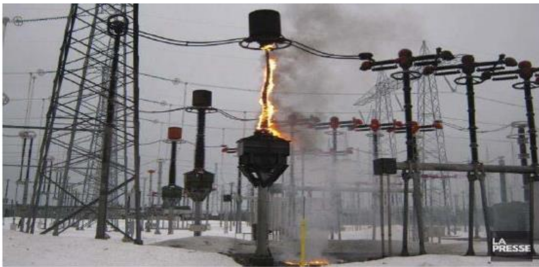
Figure 17 : Décharge dans des stations de connexion.
