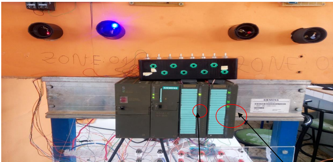
Figure III.29 : Automate S7-300 en présence de détection
