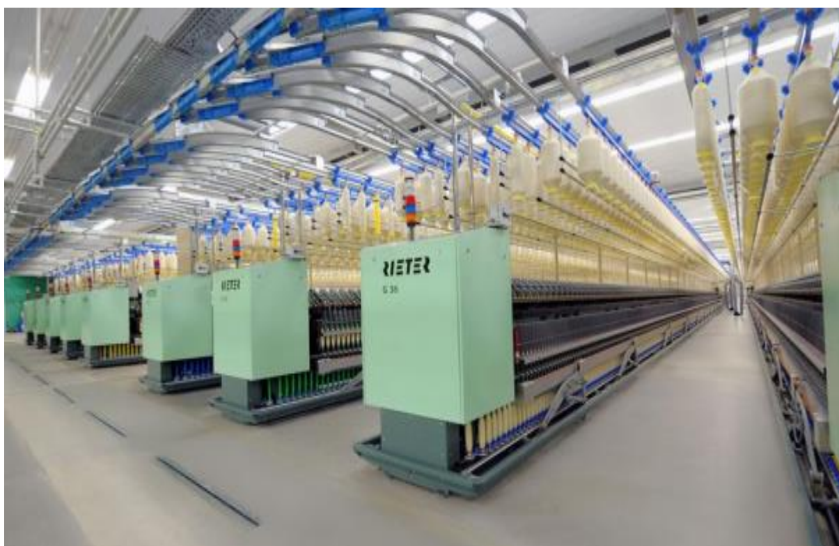
Figure II.13 : Ligne de Filage vue d'ensemble.
