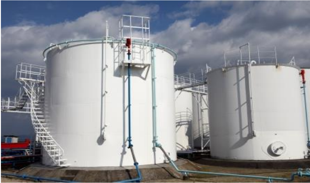
Figure 2 : réservoir d'une station d'essence (site web 2).
