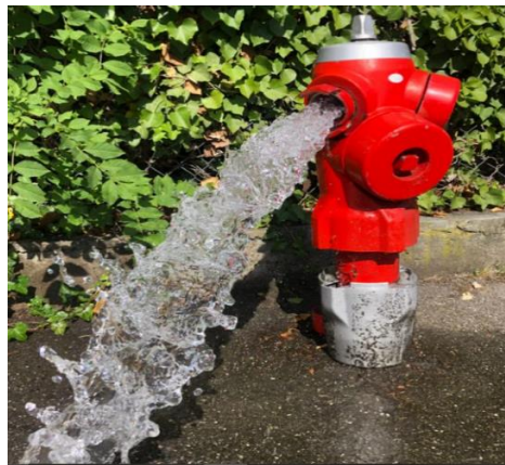
Figure 3.9 : Le poteau d'incendie (Hydrant)
