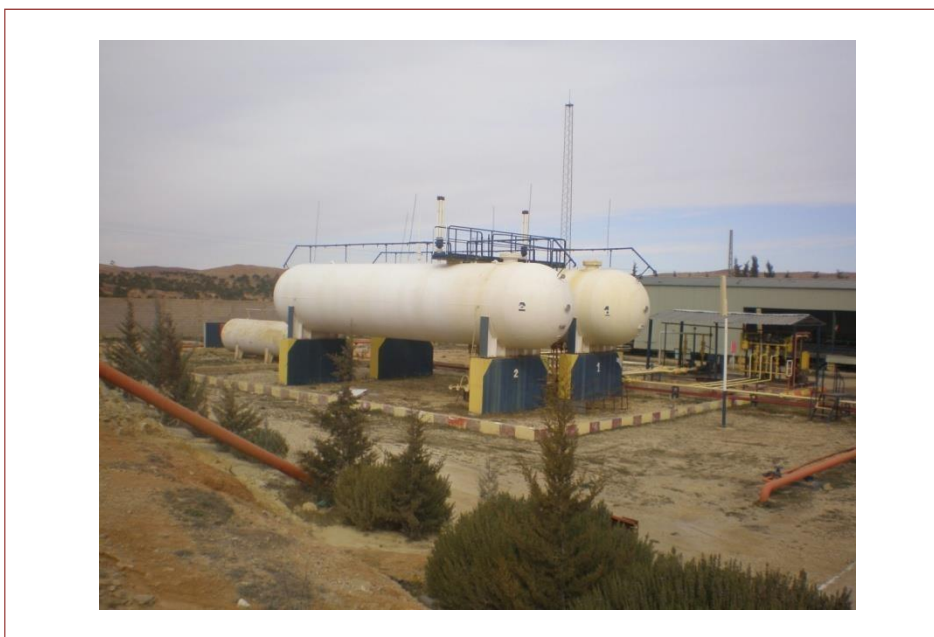
Figure N°25 : Dispositifs de rétention au sein du MCE 202 El Bayadh
