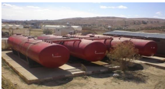
Figure N°19 : Quatre réservoirs d'eau d'une capacité unitaire de 50 m 3 (total 200m 3 ).
