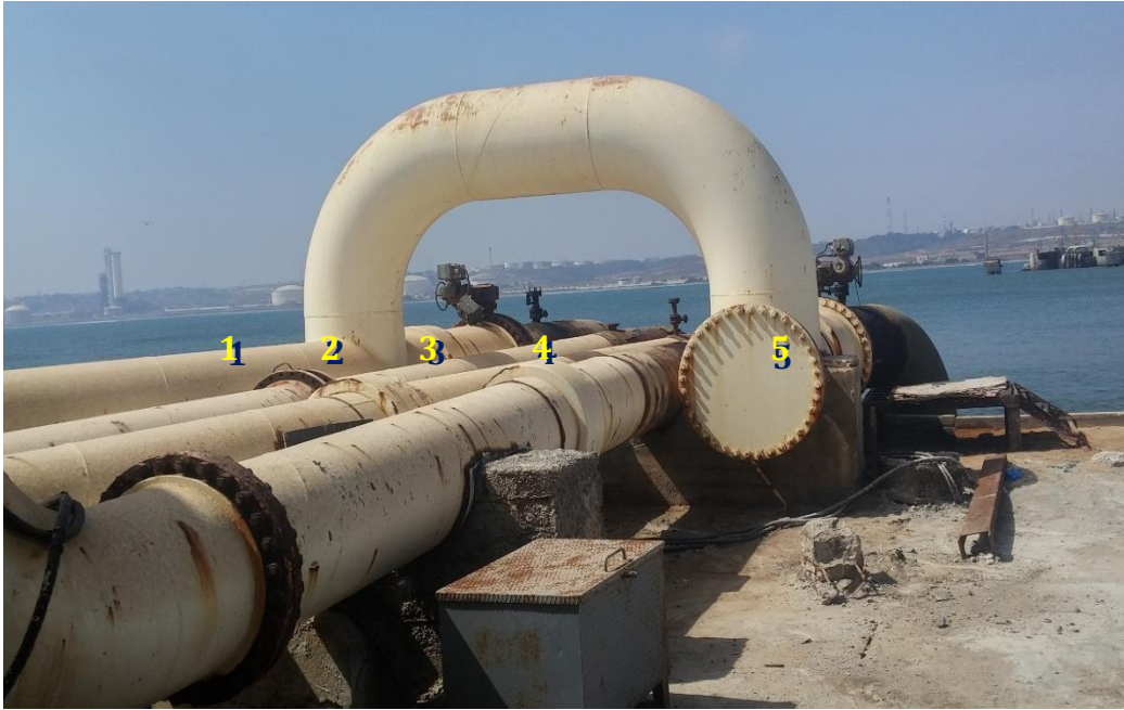
Figure 17 : Pipeline alimentation des postes de chargement d'Arzew [1]
