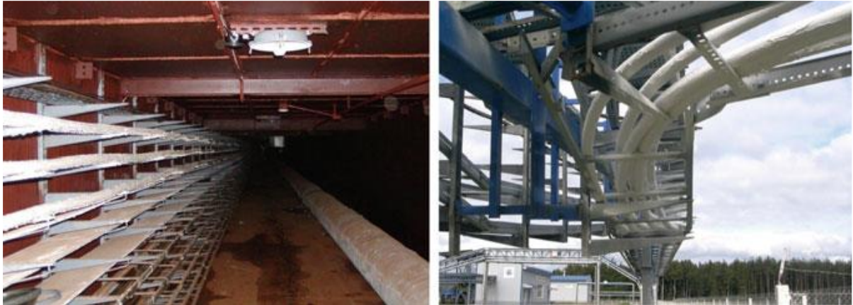
Figure II.4 : Câbles avec des matériaux intumescent.
