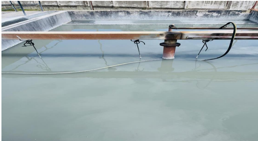
Figure II.7 : Bassin de dégazage
