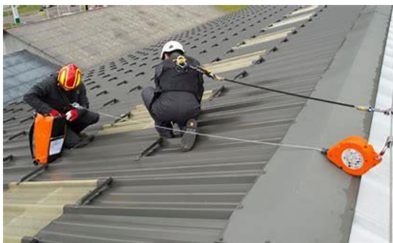
Figure 13. système de ligne de vie temporaire
