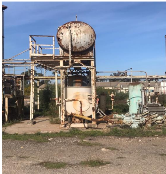
Figure III.9 - Vue du réservoir des condensats.
