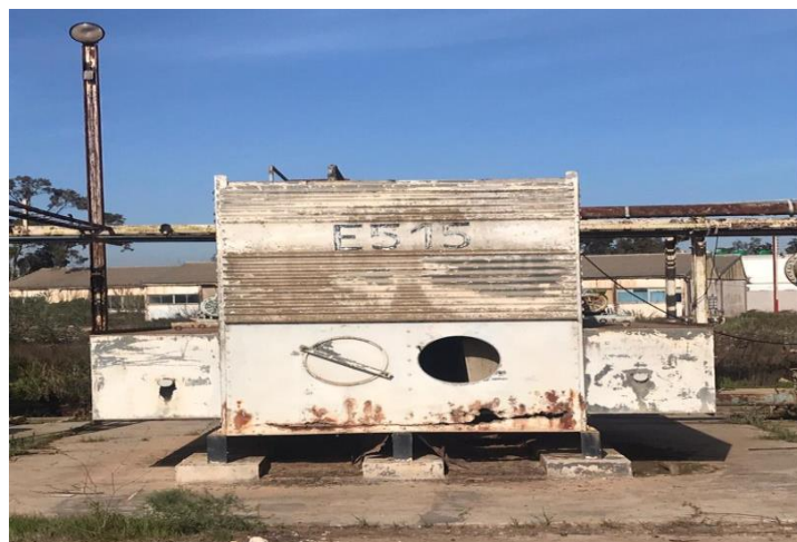
Figure III.13 - Vue d'ensemble de la tour de refroidissement.
