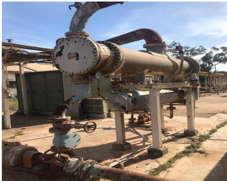
Figure III.12 - Vue d'ensemble du condenseur « SG-03N ».
