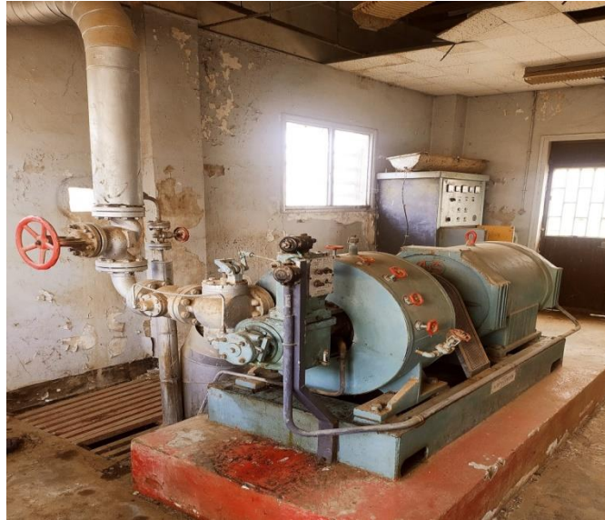
Figure III.10 - Vue de la turbine à vapeur « SG-16N »
