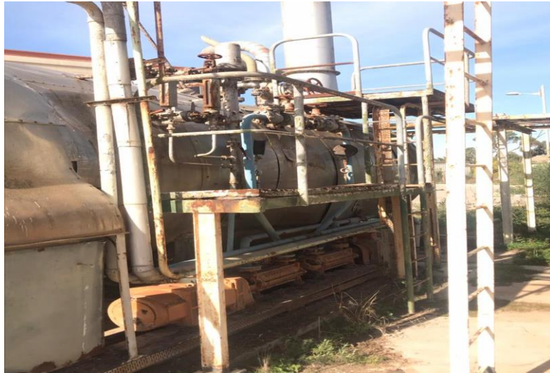
Figure III.15 - Vue d'ensemble de la pompe alimentaire
