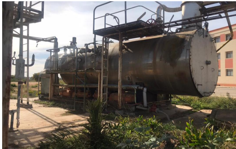
Figure III.6 - Vue de la chaudière « SG-04-N ».
