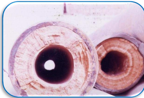
Figure I.1: Phénomène d'entartrage à l'intérieur de la conduite [1].
