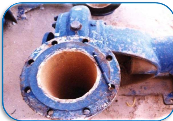
Figure I.2 : Phénomène d'entartrage au niveau du robinet [1].
