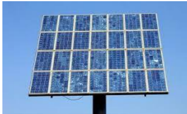
Figure 1.5 Un panneau solaire.
