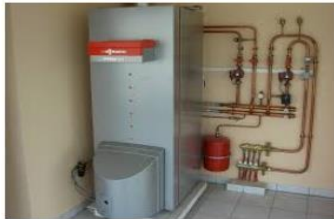
Figure 4. Chaudière à gaz sur le sol
