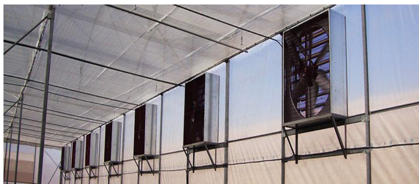
Figure I.11: Une aération forcée par extracteur d'air.
