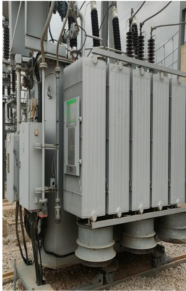
Figure II-3 : Transformateur de Puissance
