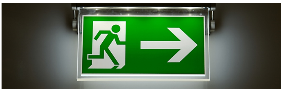
Figure 6. Éclairage de sécurité
