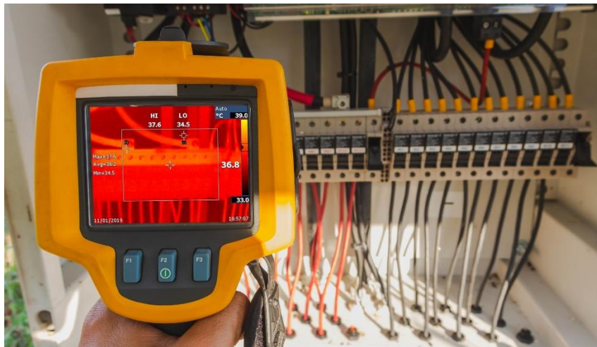
Figure 4.2 : Contrôle des installations électriques par caméra thermique.
