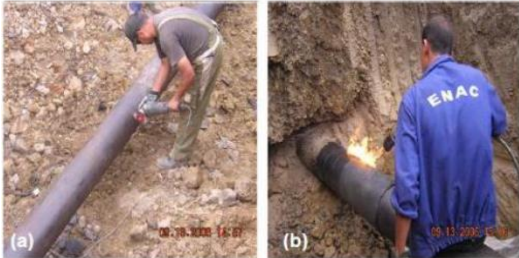
Figure I:9 réparation de surface pour réfection enrobage, fuite de benthalha (Oran,Algérie)[19]
