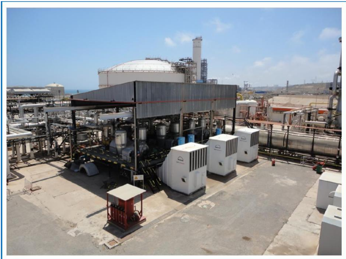
Figure N° II.1 – Turbocompresseurs TCA, TCB et TCC du complexe GP2/Z
