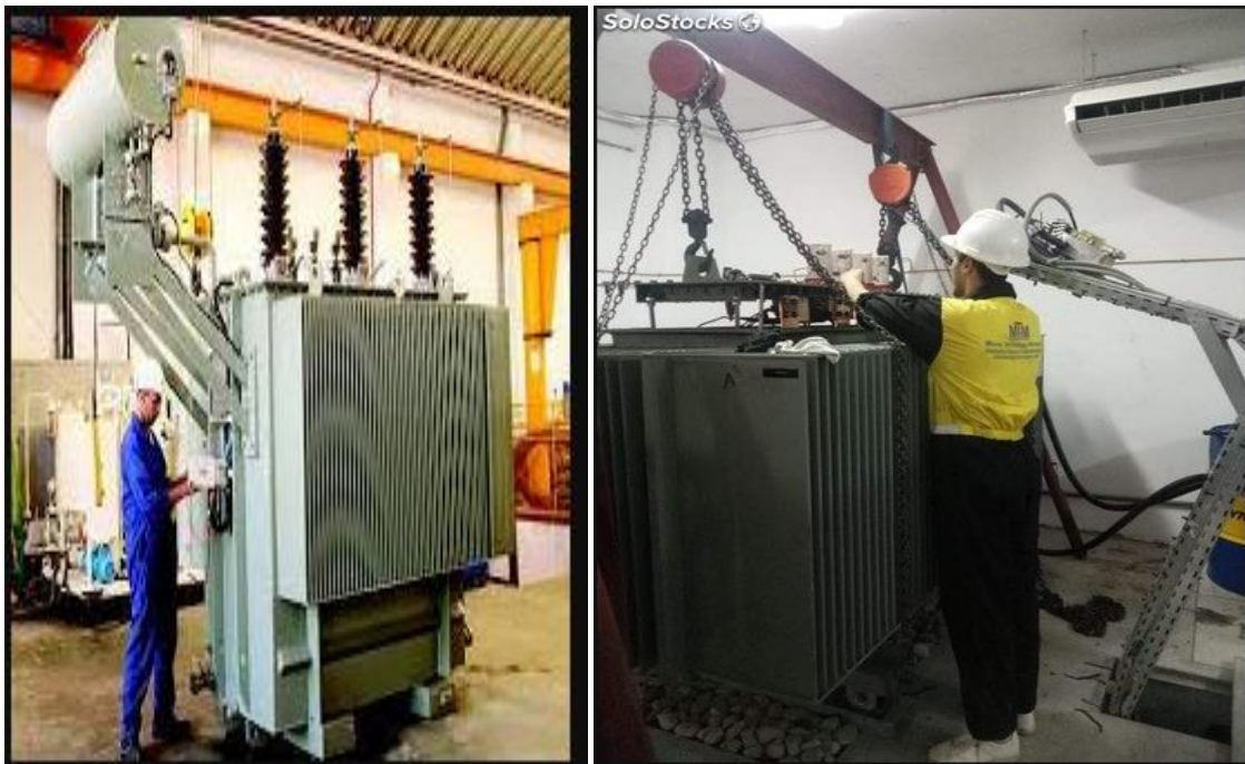
Figure (II.7) : Exemple de maintenance pour un transformateur.
