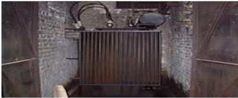
Figure (I.25) : Un ancien transformateur électrique dans une usine reconvertie
