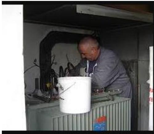
Figure (II.8) : Nettoyage d'un transformateur.
