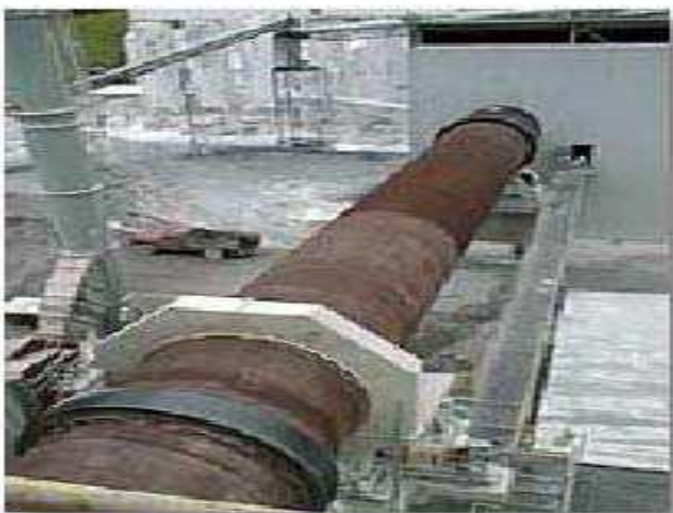
Figure III.2 : Four rotatif à incinération équipé d'une seconde chambre de combustion verticale.
