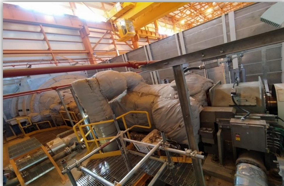
Figure 3.9 : Turbine à vapeur [13]
