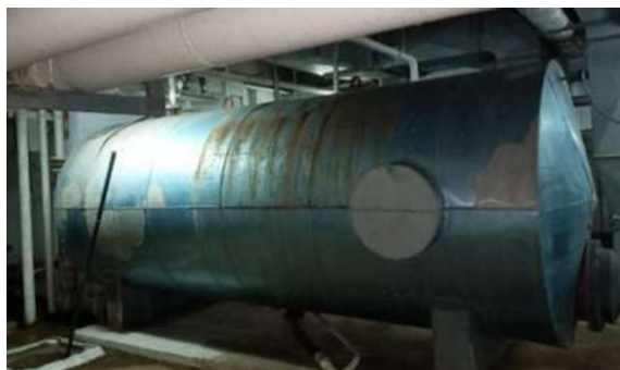
Figure II.9 : ballon d'eau chaude
