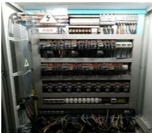
Figure III.6: armoire électrique de la piscine
