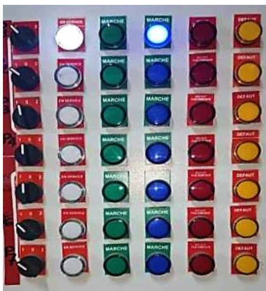
Figure III.11: Voyants lumineux de la piscine d'USTO
