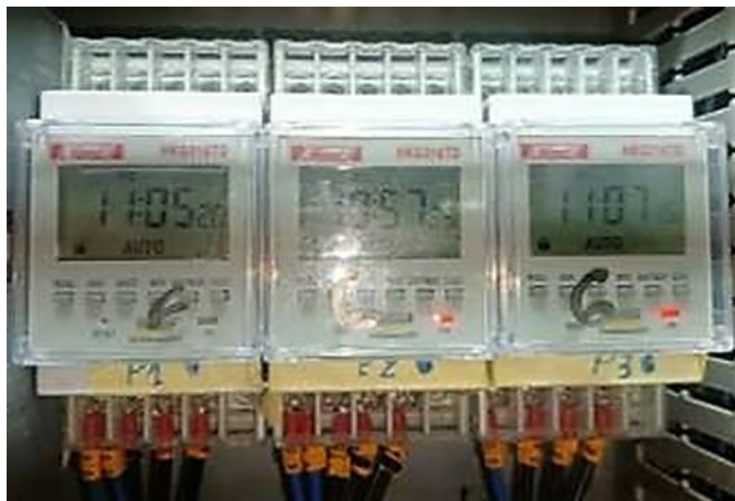
Figure III.10: horloges des pompes de la piscine d'USTO
